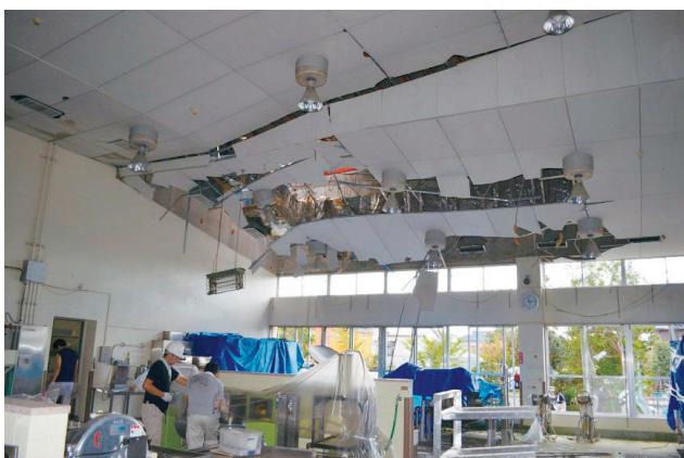
平成25年9月2日埼玉県越谷市の竜巻被害 （埼玉県越谷市提供）
